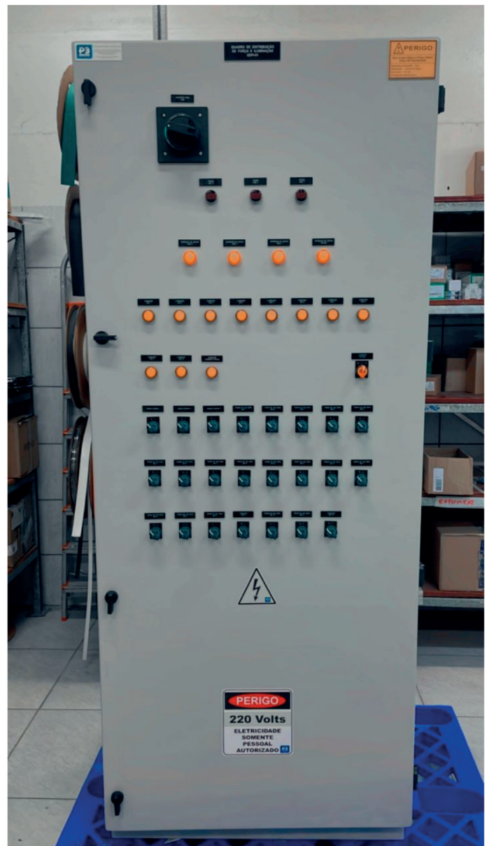
Painel Elétrico com Invólucro de Fibra de Vidro
